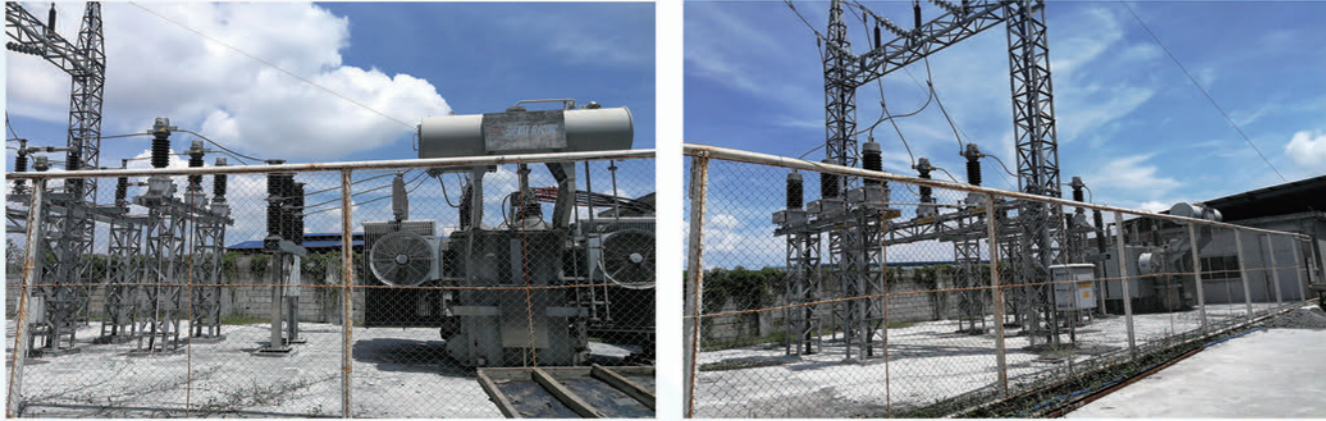
厂区内高压变电站 High Voltage Power SubStation
