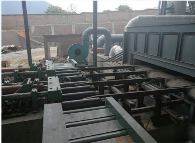
加热炉入口 Reheating Furnace Entry
